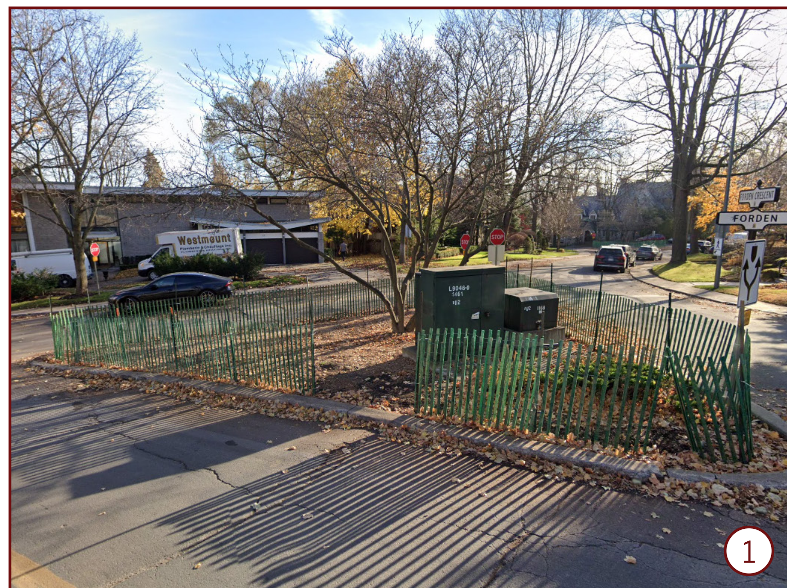
TRANSFORMATEUR / TRANSFORMER @Google Earth
